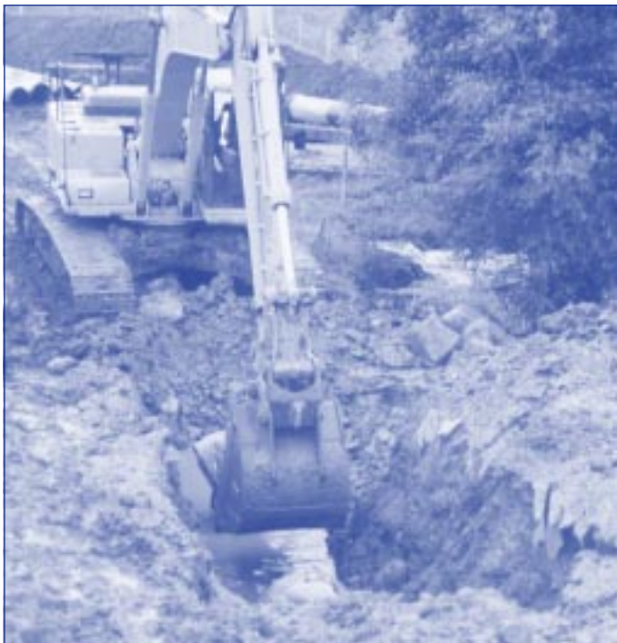
Eller Beck pipe line
